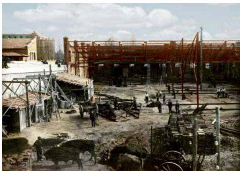
Estado de las obras de las Cocheras en primavera de 1919 (coloreada por Á. Bonet).
