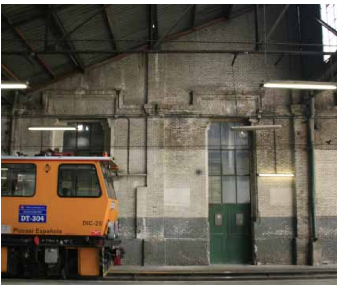
Fig.7.11- Encintado de los vanos en las Cocheras de Cuatro Caminos, 1919. Foto Álvaro Valdés
